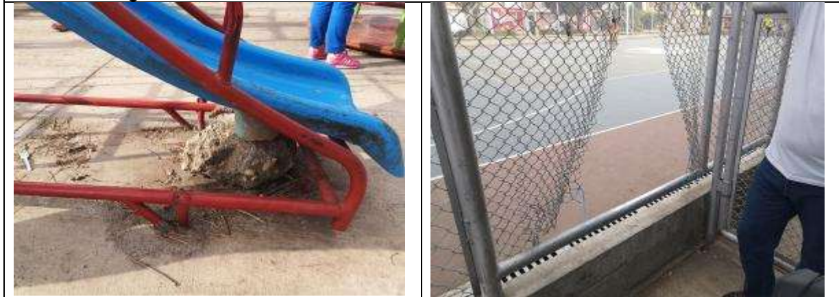
Foto No. 7: Estado del rodadero del escenario
